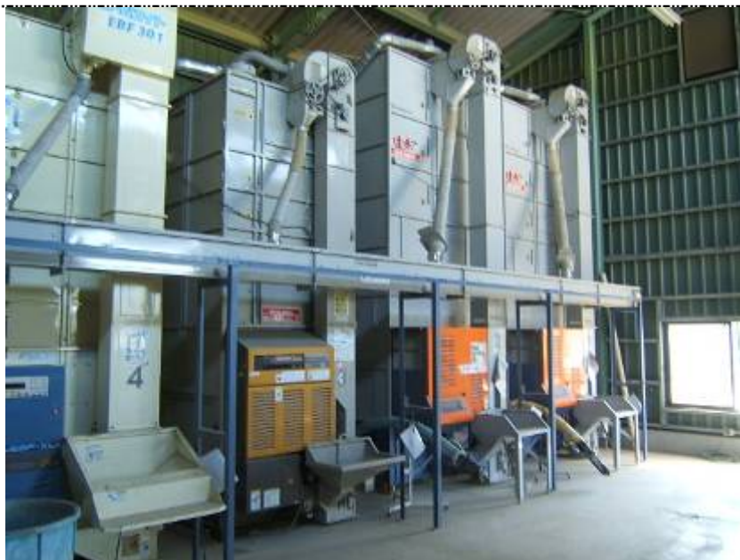
【 ライスセンター 内部・右側2台 が乾燥機(50 石・30ha対応) 】
